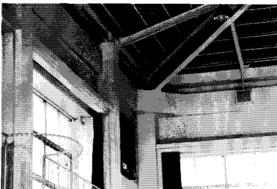
写真6 定着部コンクリートの破壊
