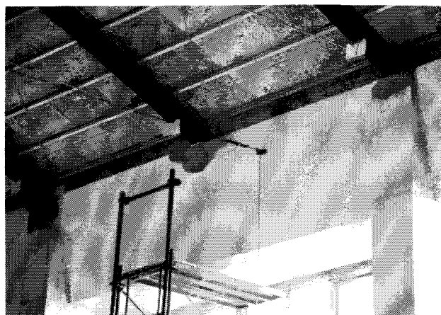
写真4 定着部コンクリートの破壊
