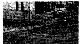
16(4) 広鶴堂前 煉瓦を突き破り噴泥、付近20cm沈下
