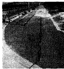
2 廿日市木材港 地割れと噴砂
