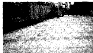
16(1) 呉高専南門付近 道路が噴泥で真っ白、舗装が浮き上がり
